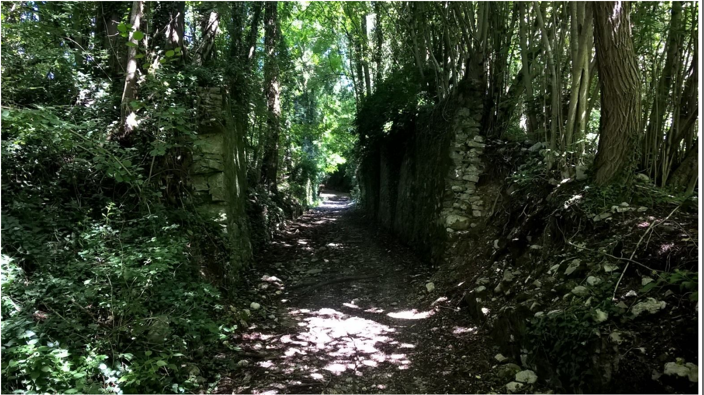
La strada presenta localmente ulteriori strettoie con crolli dei muri di cinta
