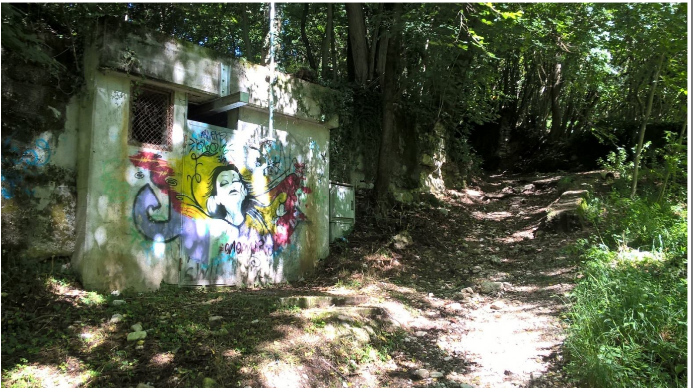
Manufatto contenente il sistema di pompaggio
