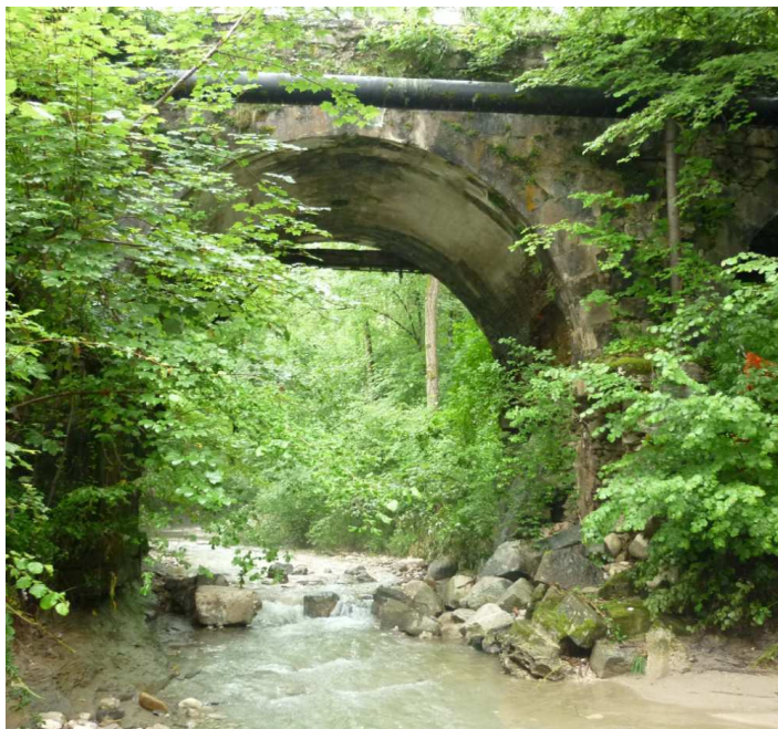
Località Casoni – ponte sul torrente, vista dall'alveo con in evidenza i gravissimi crolli che interessano la pila 1
