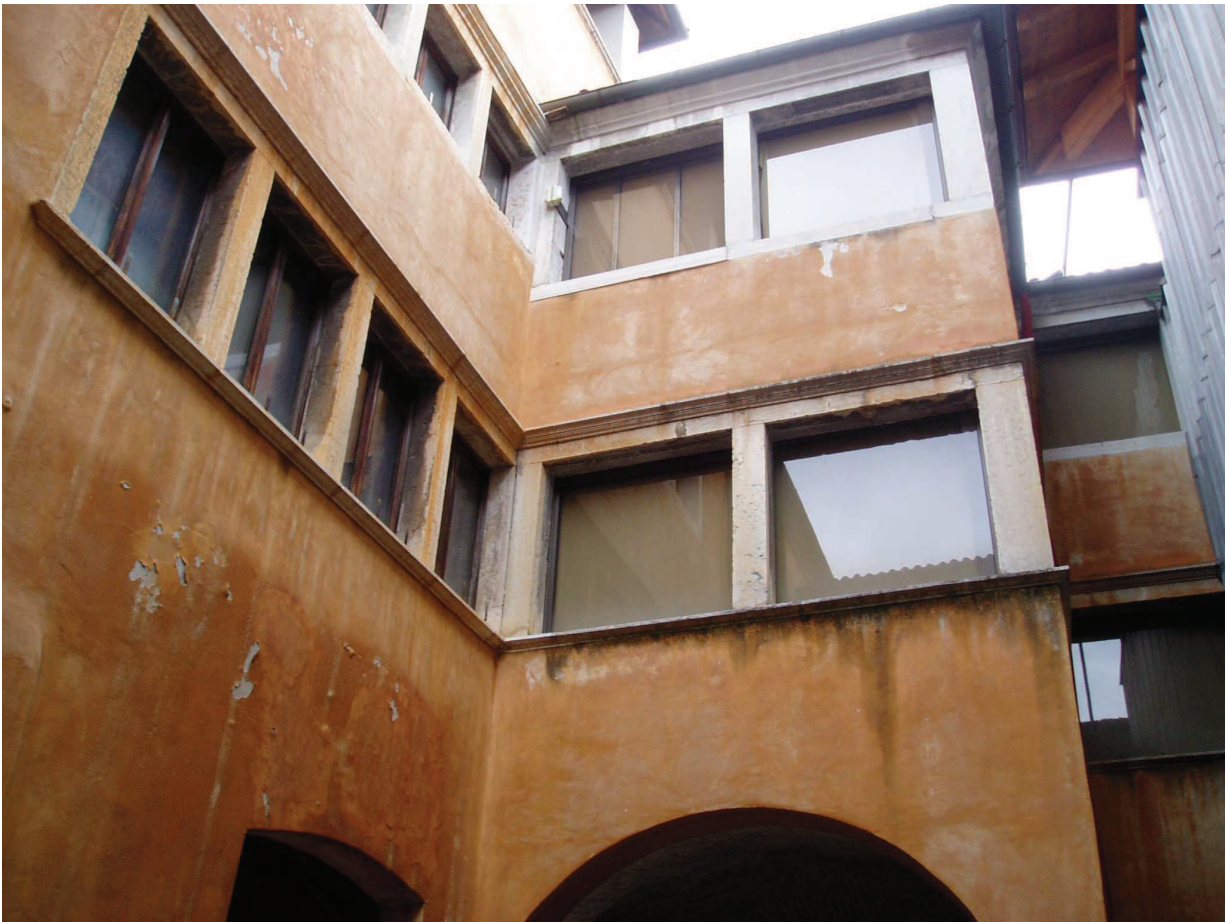
7 -La corte interna, lato nord. Angolo sud-ovest del Palazzo. A sinistra zona con pittura che si sfoglia
